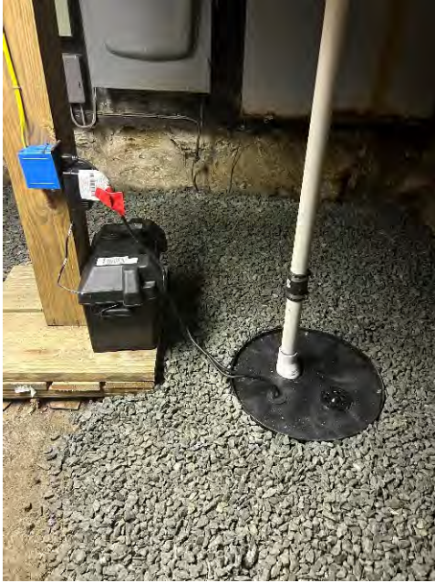
SE Sump Pump
