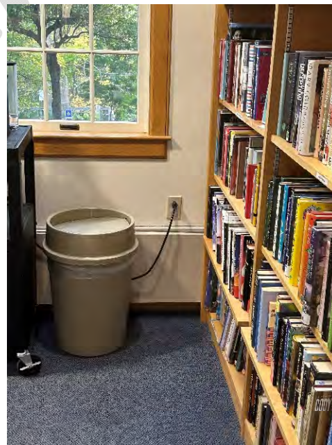
Fin Tub Radiator
